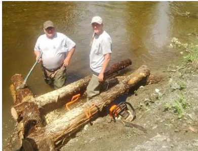
Donald et Christine : Construction de déflecteurs ruisseau Hailes. Deflectors construction on Hailes Brook.
